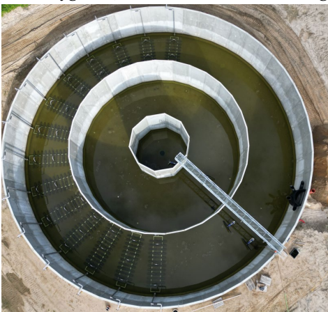
Den nye procestank
