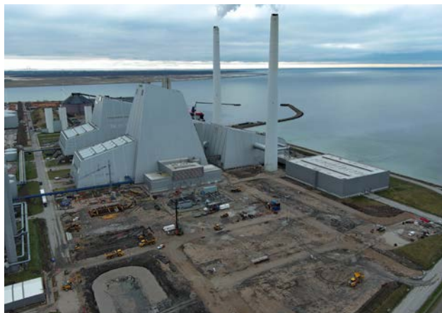
CO2 fangstanlæg ved Avedøreværket
