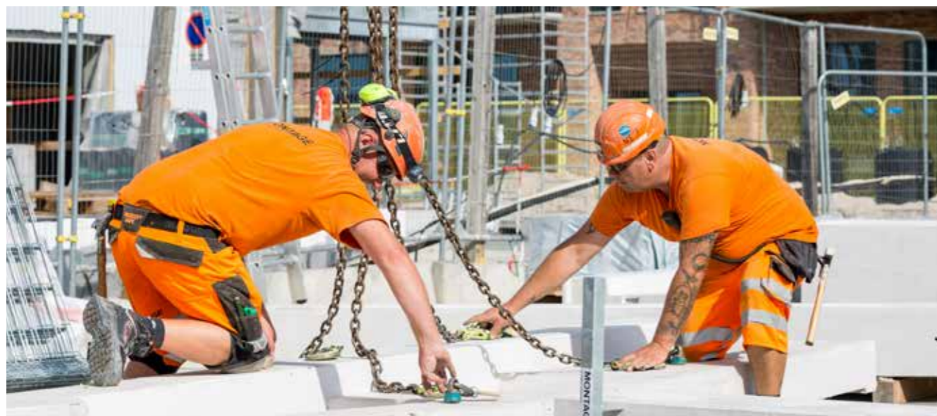
Troels og Torben med nye elementer til PensionDanmarks byggeri Sirius på Islands Brygge
