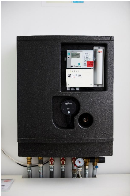
Fjernvarmeanlæg på abonnement
