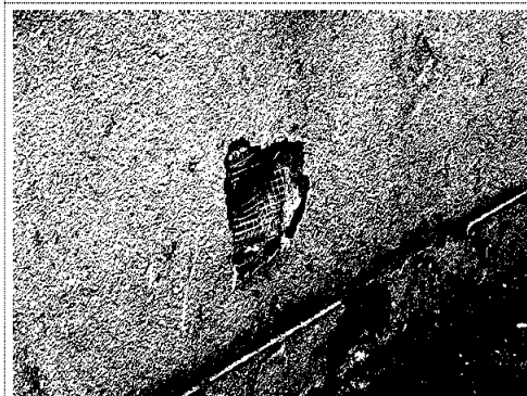
Bilde nr. 6 Utbedring av skader på systempuss ved inngangen og ved utgang til takterrassen.
