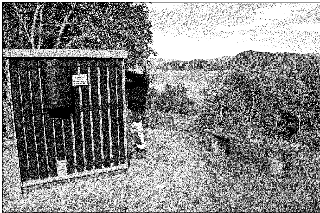
Ny nettstasjon Sassbø. Foto A. Nedal
